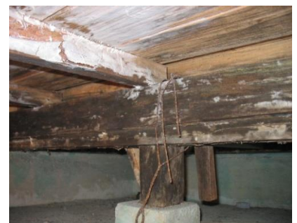
腐朽菌が発生した床下
